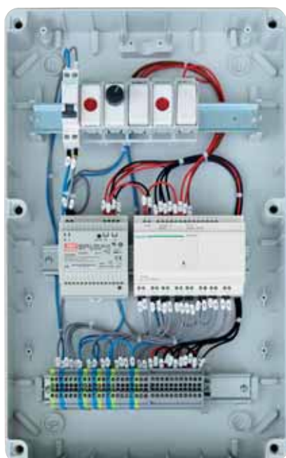
Esempio di Plc cablato Exemple de Plc câblé
